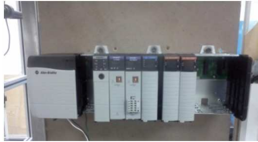
Figura 2.7: PLC Allen Bradley Utilizado para dar las secuencias de control al servo-drive
